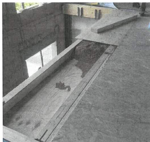
Balle de riz utilisée en isolation de plancher – Construction du siège de la CCVBA, 2018
